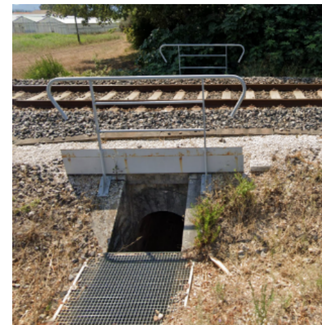
Figure 46 : Vue sur l'ouvrage en voute maçonnée rétablissant l'écoulement sans nom « SN2 » au droit de la ligne La Pauline - Hyères
