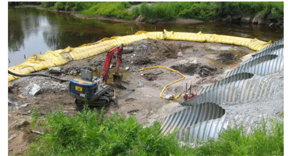
Figure 67 : exemple de batardeau souple mis en place dans le cadre de travaux sur cours d'eau quasiment à sec
