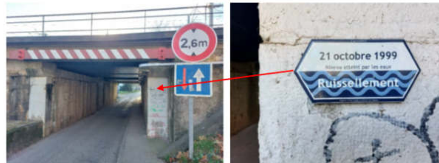
Figure 43 : repère de crue sur le Pont-Rail rue Pierre-Sémard
