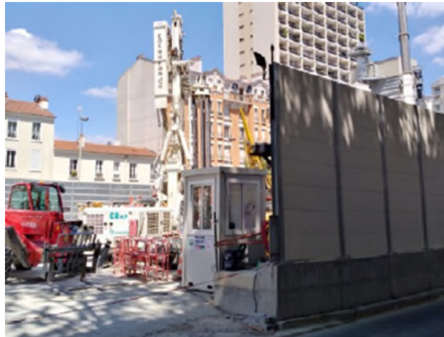
Figure 63 : Exemple d'écran absorbant provisoire mis en œuvre en limite d'emprise du chantier (Source : Acoustb)
